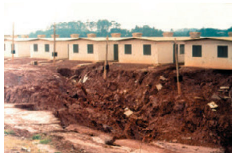
Figura 4 – Detalhe do mesmo Conjunto mostrando o poder destrutivo do processo erosivo. (Foto IPT)
