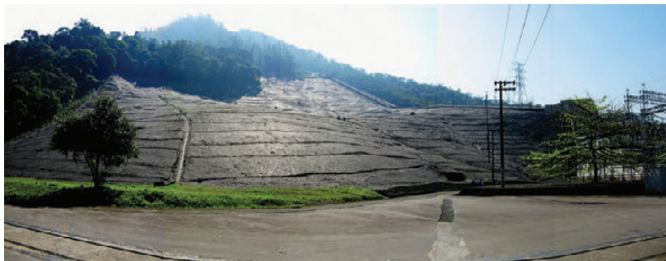
Grande escorregamento em corpo de íalus que por pouco não destruiu a casa de força da Usina Henry Borden em Cubatão. Foi estabilizado através de um denso sistema de drenagem profunda e de sua total impermeabilização superficial. (Foto do Autor)
