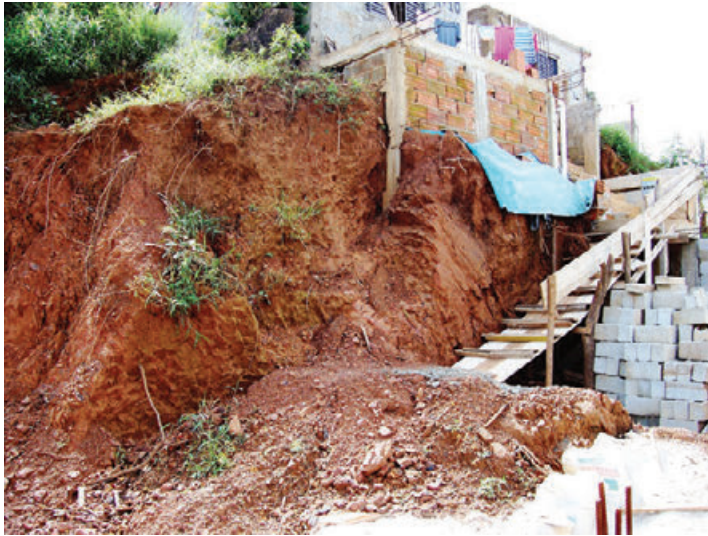
Cena comum: desestabilização de casa já construída pela escavação de lote vizinho. A escavação do lote desestabiliza o terreno superior, pelo corte, e o inferior, pelo lançamento abaixo do material escavado. (Foto do Autor)
