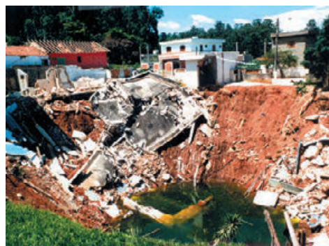
Figura 6 – Estágio final da colonização. A água ressurge a cerca de oito metros de profundidade (7/1/87). (Foto IPT)
