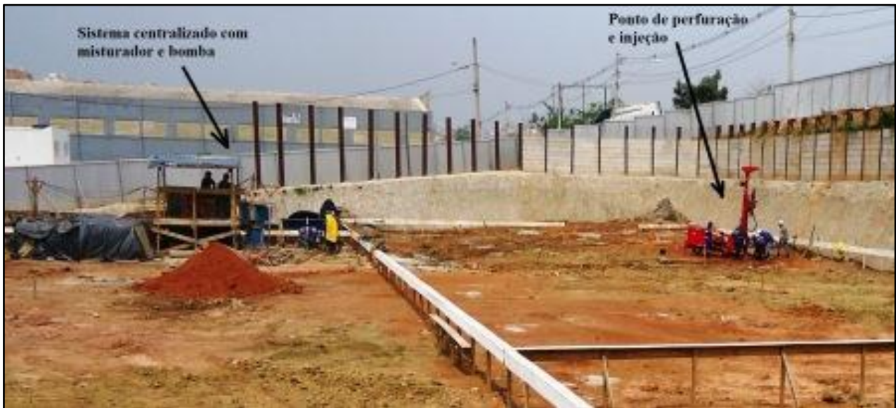
Fig 21 – Sistema centralizado com misturador e bomba atendendo vários pontos de injeção. Foto ARSantos
