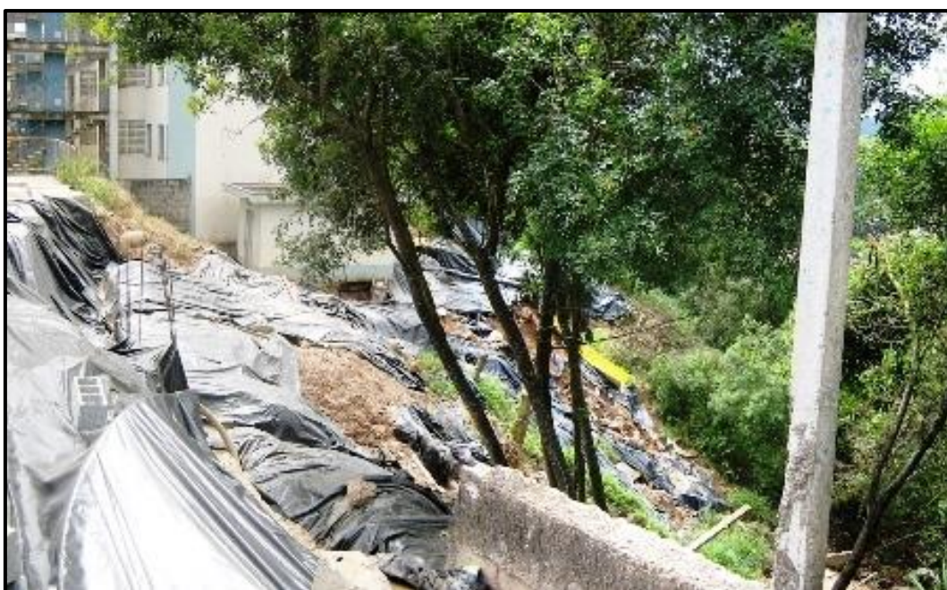
Conjunto Residencial da CDHU construído em cabeceira de grota contribuiu com a reativação de sua dinâmica evolutiva. Franco da Rocha SP. Foto do autor.
