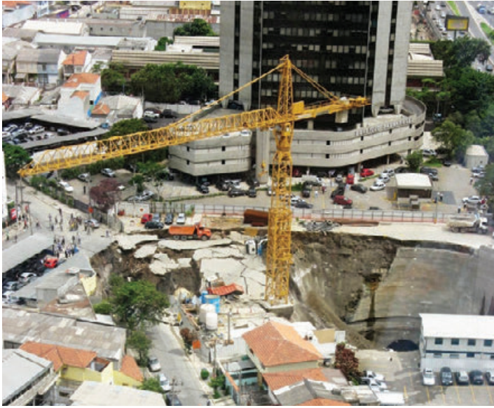
Colapso do túnel da Linha 4 do Metrô paulistano, Estação Pinheiros, em 2007. Muito provavelmente, a boa Geologia e a boa Geotecnia se deixaram sufocar por uma gestão de obra especialmente comprometida em reduzir prazos e custos. (Foto Ana Carmem)
