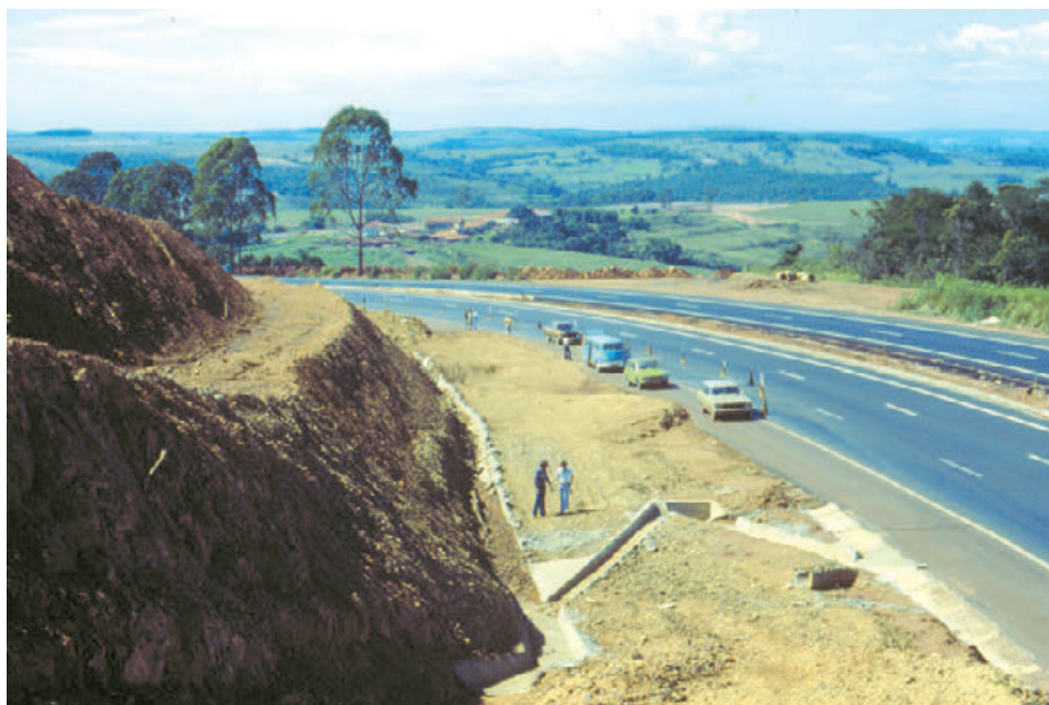
Figura 1 – Notar a dimensão do talude e os primeiros efeitos do escorregamento (levantamento) sobre a pista ascendente da rodovia; logo em seguida, inteiramente interditada. (Foto do Autor)
