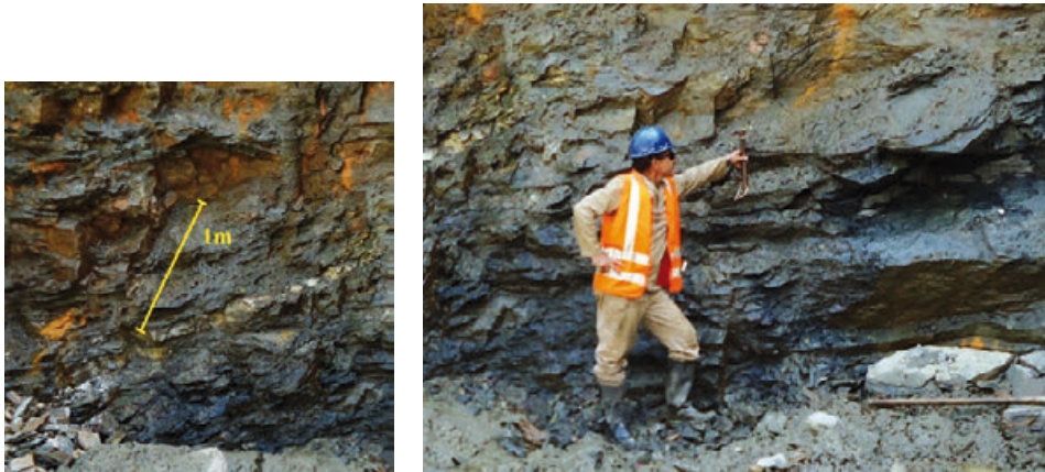
Figura 1 e 2 – Detalhes das frentes de escavação do maciço de fundação mostrando o alto grau de conturbação estrutural, petrológica e intempérica do maciço de fundação. (Fotos do Autor)
