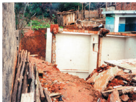
Figura 4 – A primeira residência tomba no interior do buraco (25/8/86). (Foto IPT)
