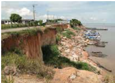
Terras caídas. Parintins – AM. Foto: CPRM
