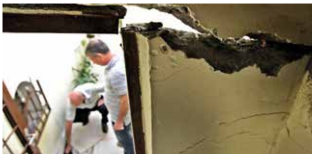
Rachaduras e danos estruturais em imóveis vizinhos a locais submetidos a rebaixamento forçado do lençol freático. Situações mais comuns em áreas baixas aluvionares com nível freático próximo à superfície
